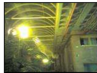
Diferencial térmico de 8 °C entre el lucernario y el techo.
