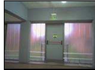
Infiltraciones de aire por la parte superior de la puerta de emergencia.
