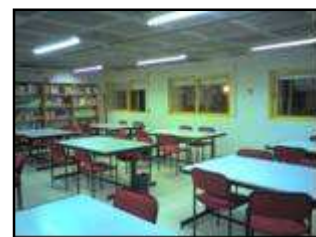
Doble ventana en la biblioteca. Se observa mínimas infiltraciones de aire a través de las juntas de las mismas.
